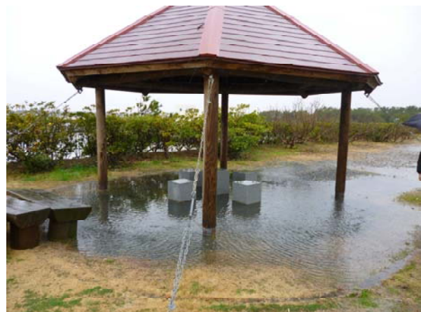
写真-5 東屋の水没状況
