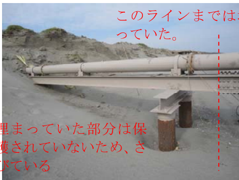
(写真1 3) 配管露出状況
