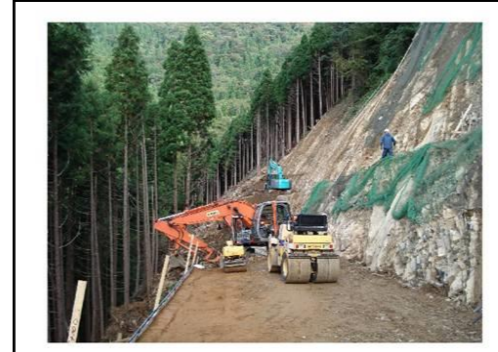
【林道の整備】 宝仏山及び窓山周辺の森林整備を進めるため林道を開設している。完成した林道は、森林に親しむ道としても広く利用されている。(日野町金持)
