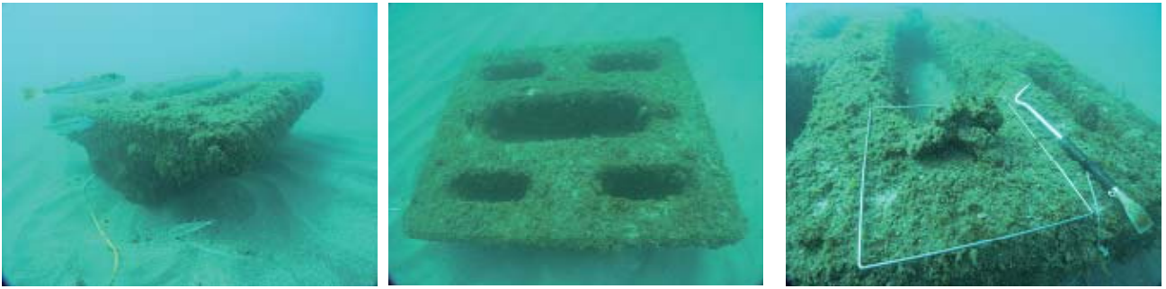
図11 定点2東端側π型礁-⑦(左:外観, 中央:天端, 右:力キ付着)
